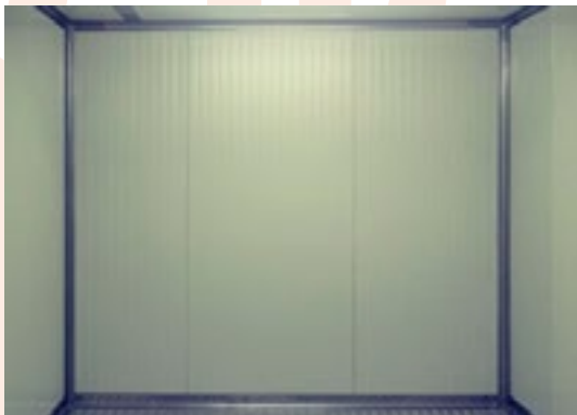
Figura 5: Paredes y techos de color claro, de acabado liso, impermeable y fácil de limpiar
