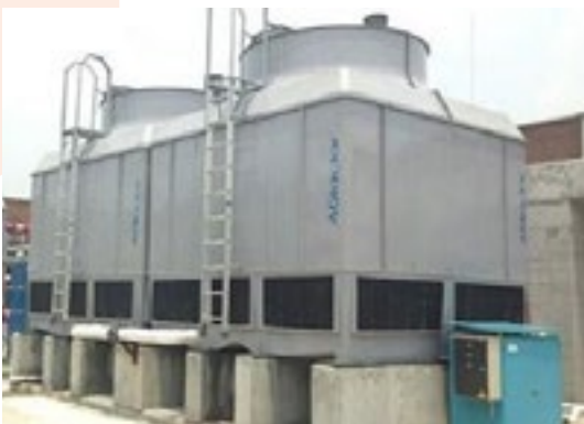
Figura 34: Torres de enfriamiento ubicados en áreas externas
