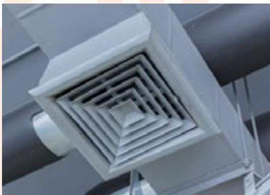
Figura 17: Rejillas de un sistema de ventilación
