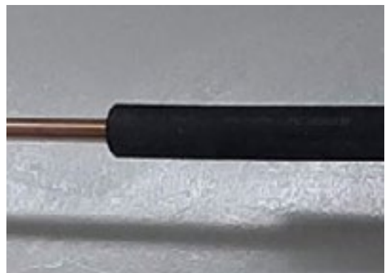
Figura 9: Tubería con aislamiento de espuma elastomérica para evitar la condensación o goteo
