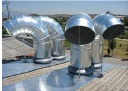
Figura 18: Toma de aire de un sistema de ventilación en techos
