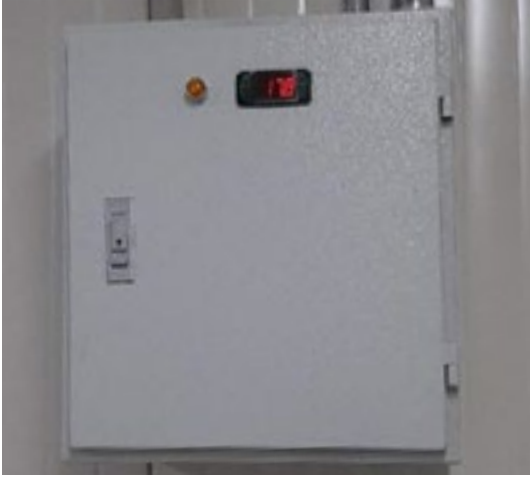
Figura 33: Dispositivo de control de temperatura en ambiente
